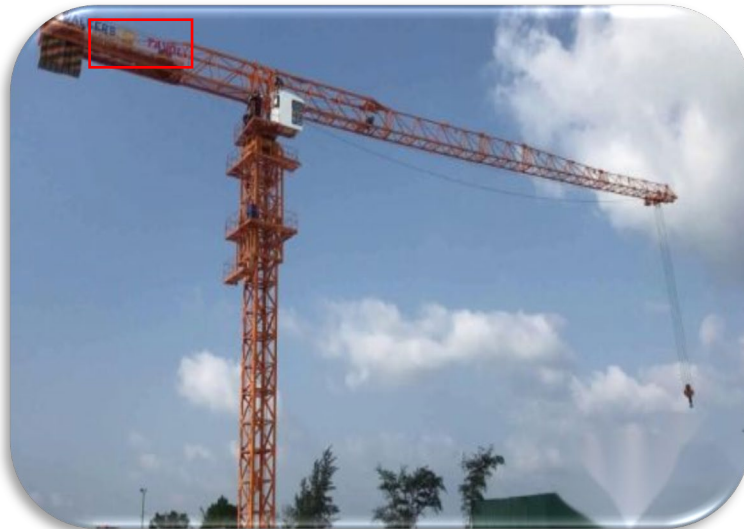
Figura 13: Contra pluma de la grúa torre
